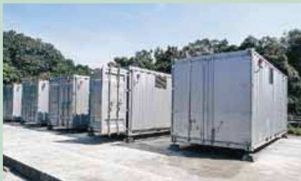
Geradores garantem energia para a população da Ilha
